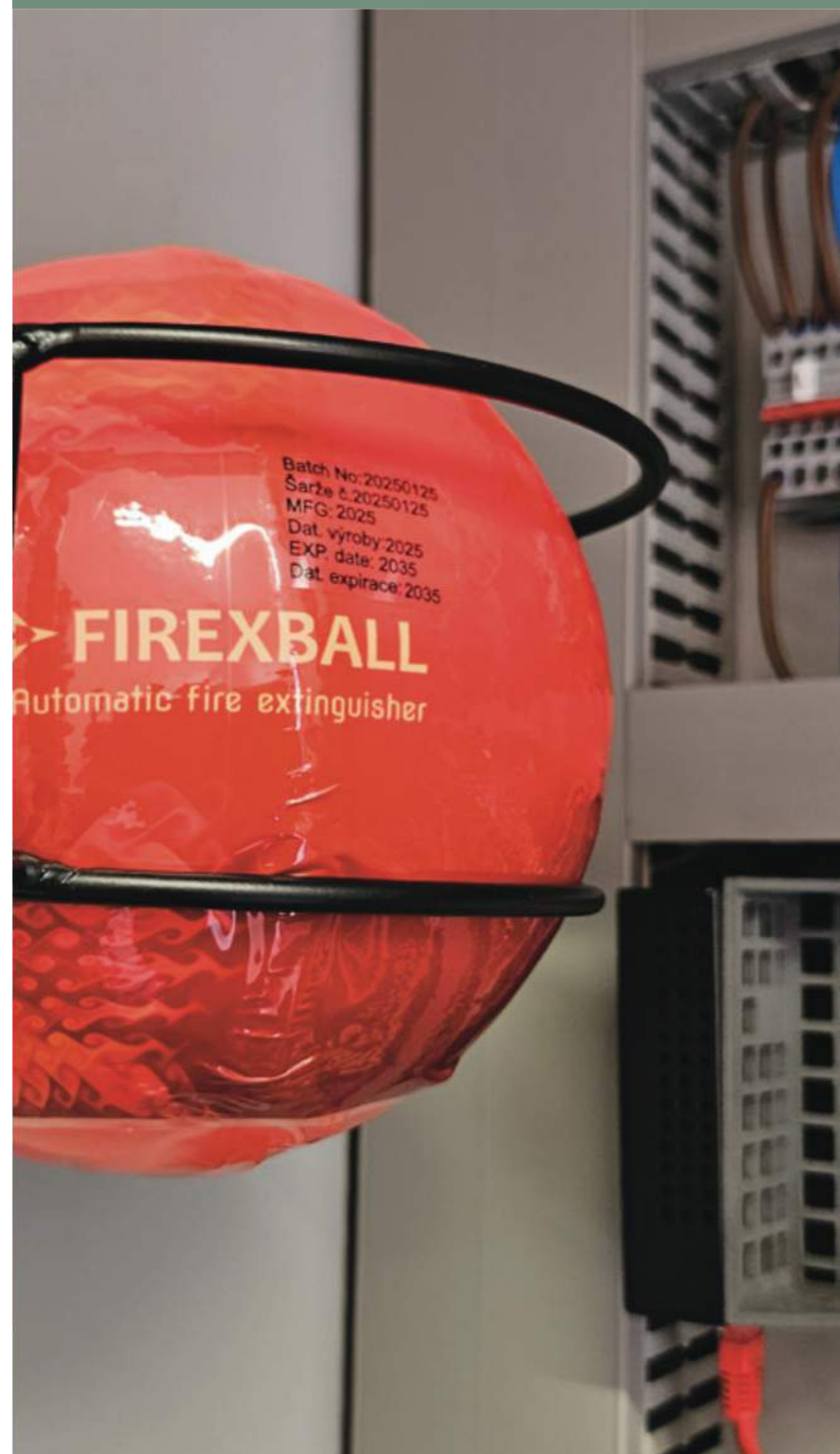
Sistema automático de extinción de incendios
