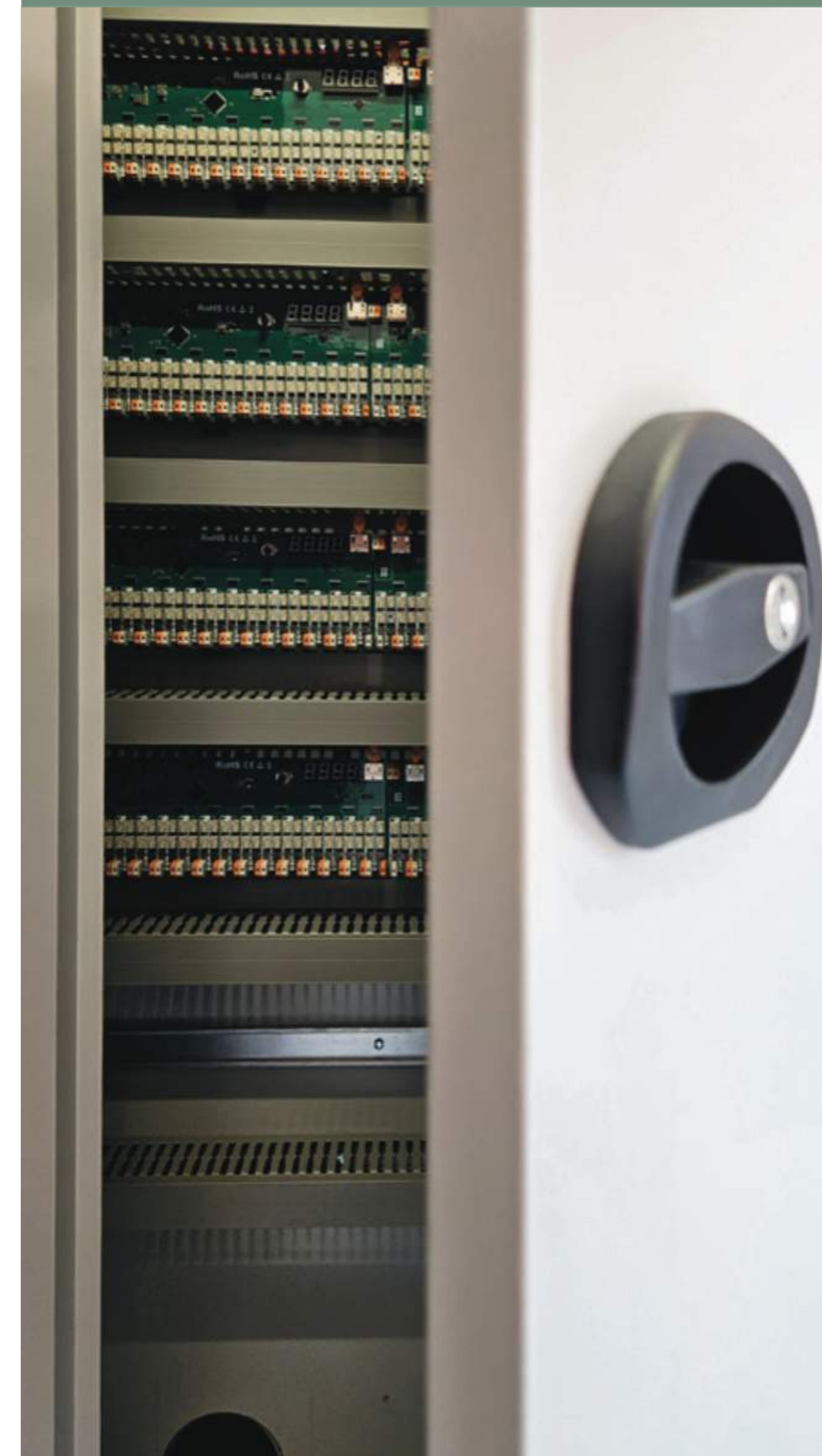
Armario eléctrico con cerradura
